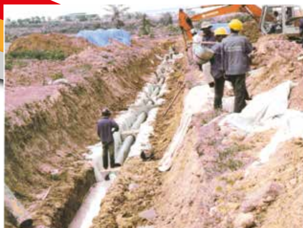
TRẠM XLNT KCN CHÂU ĐỨC BÀ RỊA VŨNG TÀU
